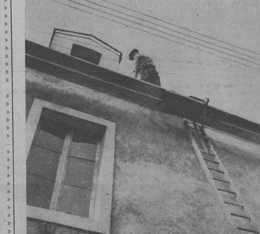
ECHAFAUDAGE SA NS GARDE-CORPS : UN FAUX-PAS ET C'EST LA CHUTE...
