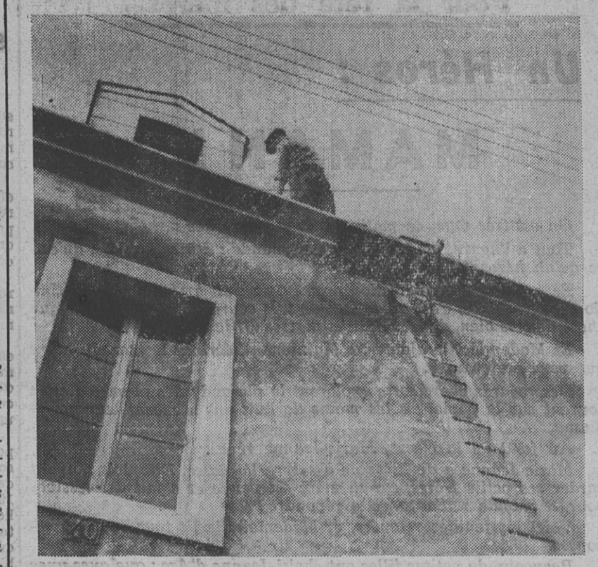
Echafaudage sans garde-corps : un faux pas et c'est la chute...
