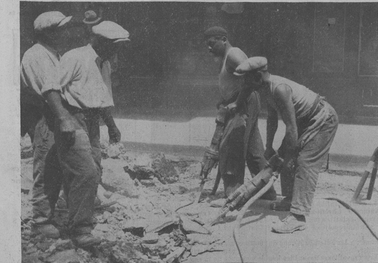
Pour refaire une chaussée plus « roulante » on peine sous le grand soleil
